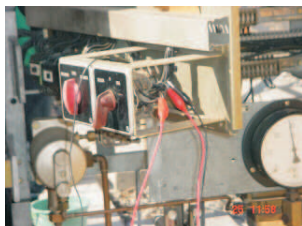
Detalhe das garras do cabo de comando instaladas no painel do disjuntor
